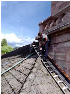
Witterungsbeständige Kupferbeschläge im Dachbereich
