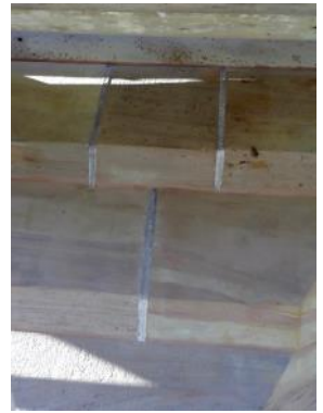
7: Bleiverplombungen als Verwitterungsschutz
